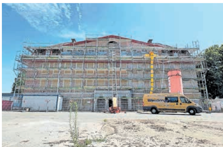
Noch erledigen die Handwerkerinnen und Handwerker die abschliessenden Arbeiten am Schulhaus – die Räumlichkeiten können schon bezogen werden.
